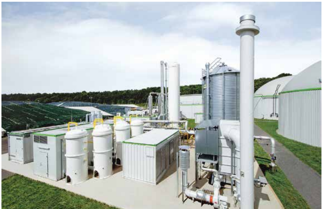
Anlage zur biologischen Methanisierung von CO 2 und Wasserstoff © microEnergy GmbH
