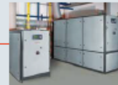
Blockheizkraftwerke zur Wärme- und Stromerzeugung
