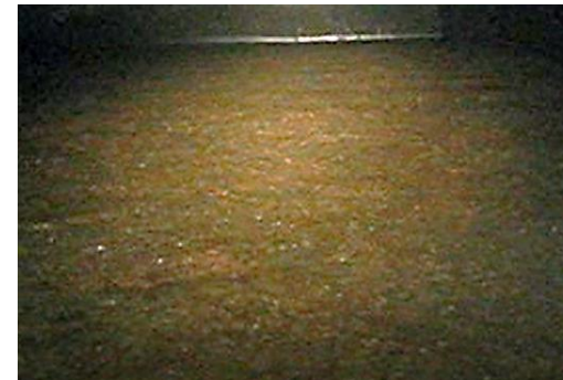
Blick in Biogas-Fermenter (Bild: Dr. Bernd Krautkremer, Fraunhofer IEE)
